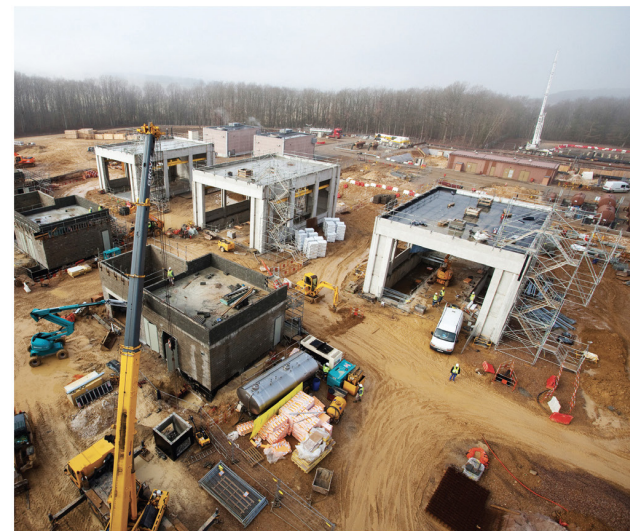
Plateforme de stockage gaz – Saint-Clair-sur-Epte (95) – Projet MA4
