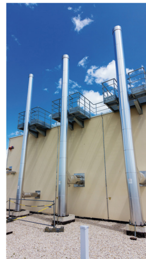
Détail cheminées des chaudières
