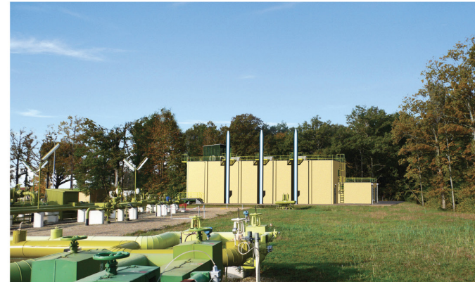
Chaudière industrielle – Etrez (01)
