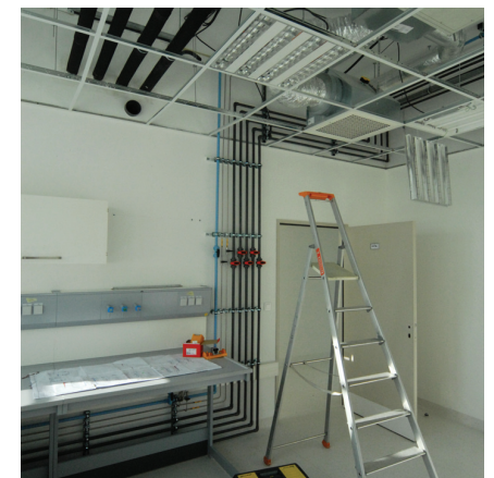
Maintenance des fluides spéciaux
