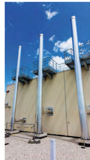
Détail cheminées des chaudières
