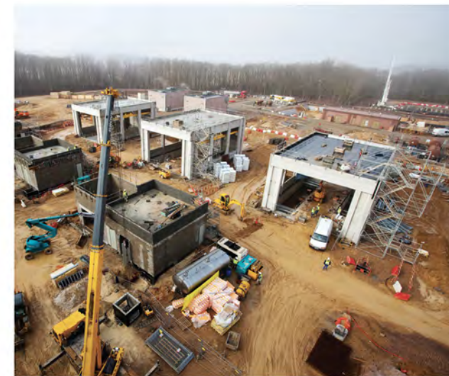
Plateforme de stockage gaz – Saint-Clair-sur-Epte (95) – Projet MA4
