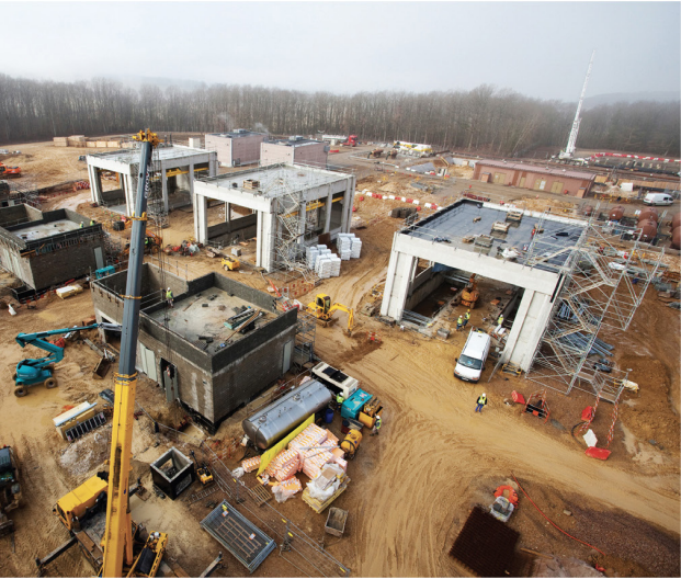
Plateforme de stockage gaz – Saint-Clair-sur-Epte (95) – Projet MA4
