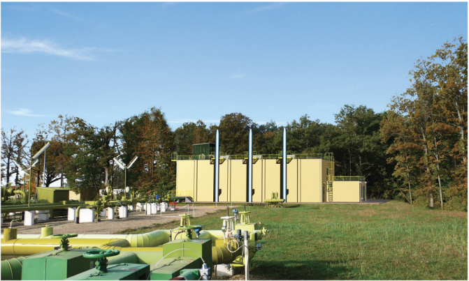
Chaudière industrielle – Etrez (01)
