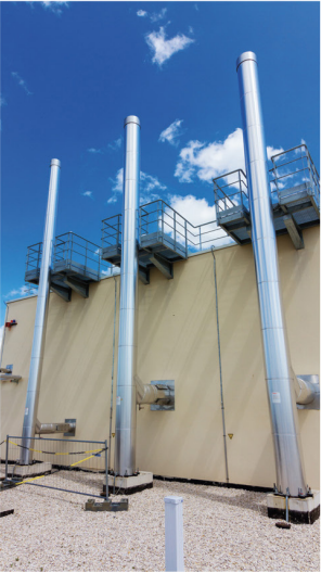
Détail cheminées des chaudières
